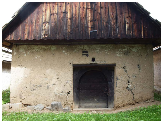
► Obr. 27. Fasáda s hlinenou omietkou, na ktorej bol vápenný náter. Zachovali sa z neho len malé zvyšky na chránených miestach pod strechou.
