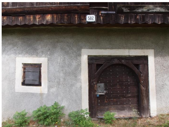
Obr. 30. Plocha fasády pokrytá omietkou so striekanou vrchnou vrstvou – lemy okolo architektonických otvorov sú hladené a obielené vápnom.
