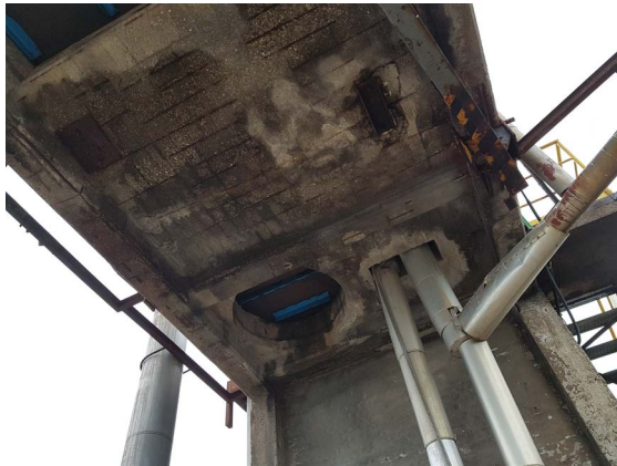
► Obr. 3. Korózia výstuže objektu 42_15 Duslo.
