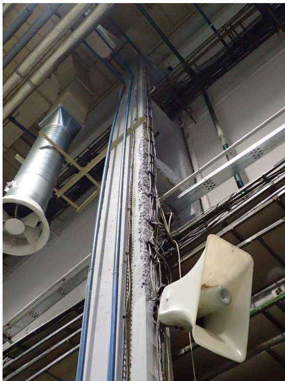
► Obr. 14. Kaverna na prefabrikovanom stĺpe, hala Považská Bystrica.
