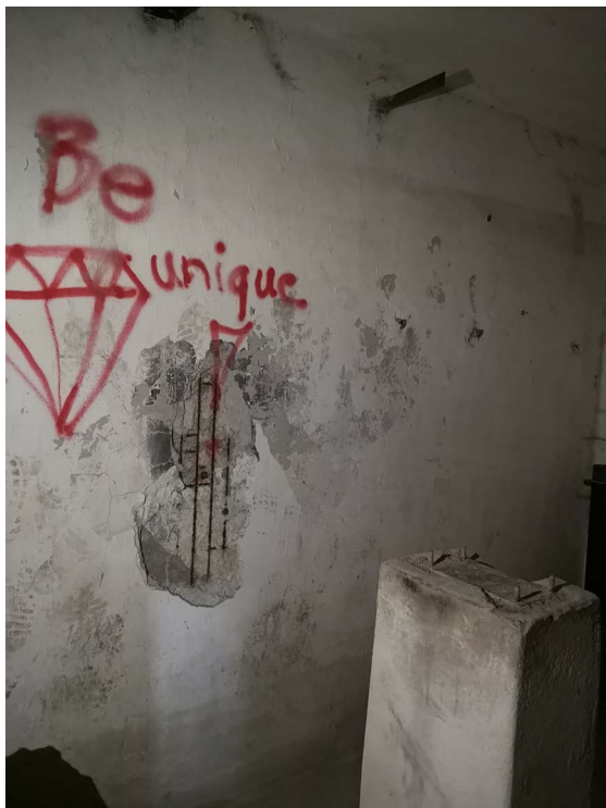
►► Obr. 7. Výkvetý na stene, Bunker B-S4, Bratislava-Petržalka.
