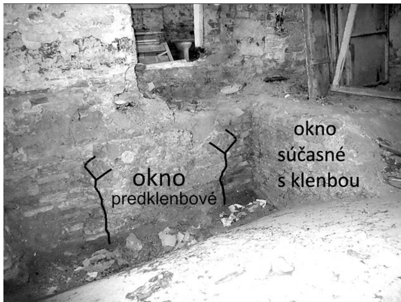
Obr. 9. Suterén A, interiér pri poblade z 1.NP po odstránení zásypu nad klenbou, bočná – južná stena s vyznačením pôvodného okna smerujúceho do parcely, ktoré klenba znefunkčnila a okna, ktoré akceptovala.
