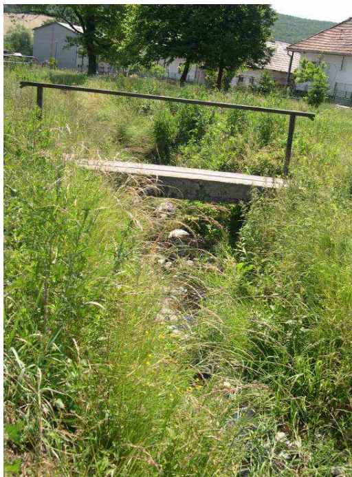
10. Nevhodné riešenie lávky cez potok zo železobetónových panelov
