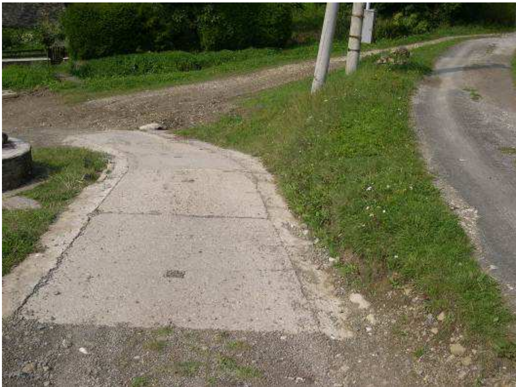
Obr. 132 – miestna komunikácia – nevhodný povrch - železobetónové panely
