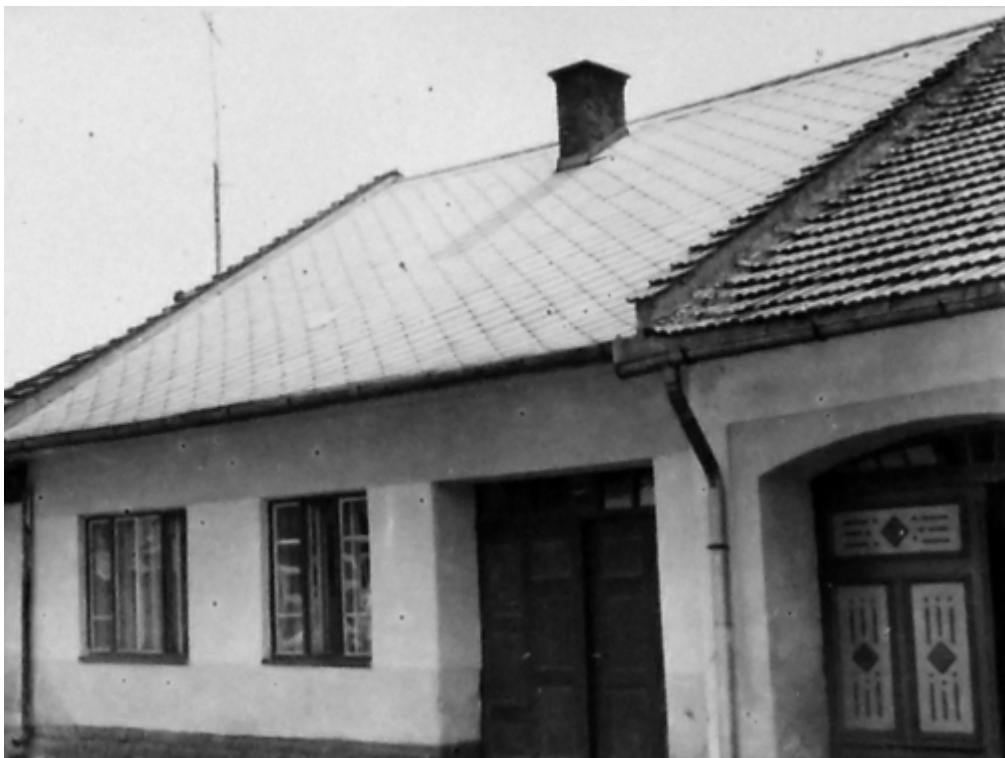
246. Bernolákova ulica č. 1086/10, parc. č. 471 – pôvodný objekt staré súp. č. 237 v roku 1962 (zdroj: Archív Pamiatkového úradu SR, Borodáč, č. negatívu 44711)
