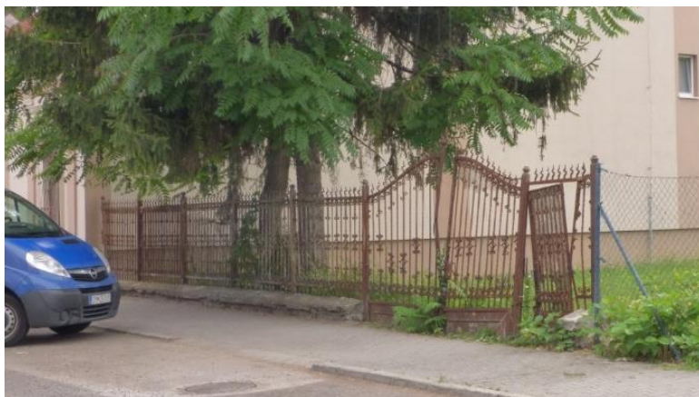
24. Oplotenie na Robotníckej ulici, parc. č. 668
