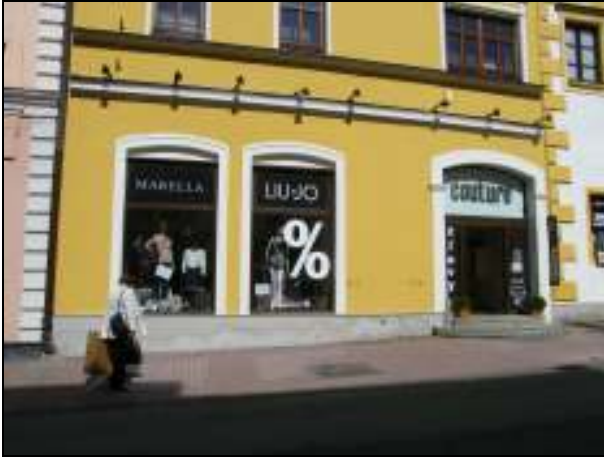
37. Dolná 10. Neprimeraná veľkosť otvorov v mieste pôvodných okien, nevhodný tvar výkladov so segmentovým záklenkom.
