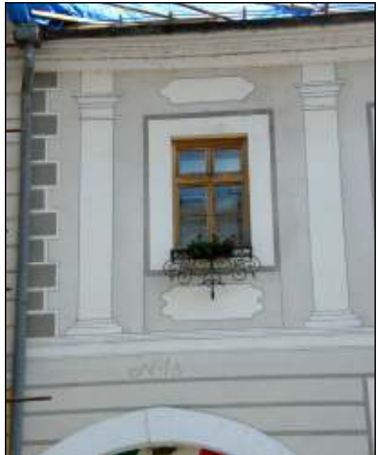
8. Dolná 1. Rekonštrukcia neskorobarokovej maľovanej výzdoby na 2.NP fasády s členením iluzívnymi pilastrami, koniec 18. storočia.
