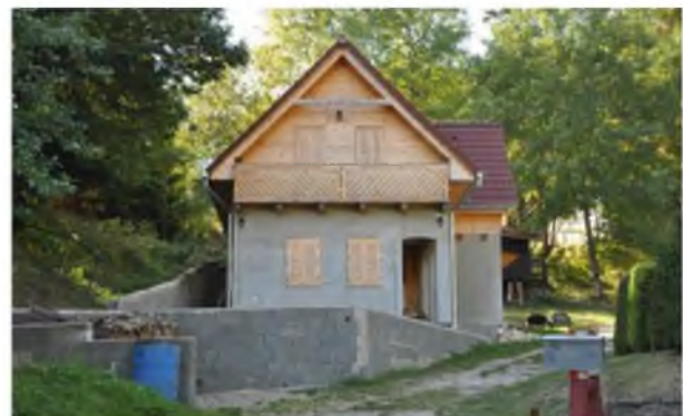
Vysoká nadmurovka a nevhodné detaily strechy
