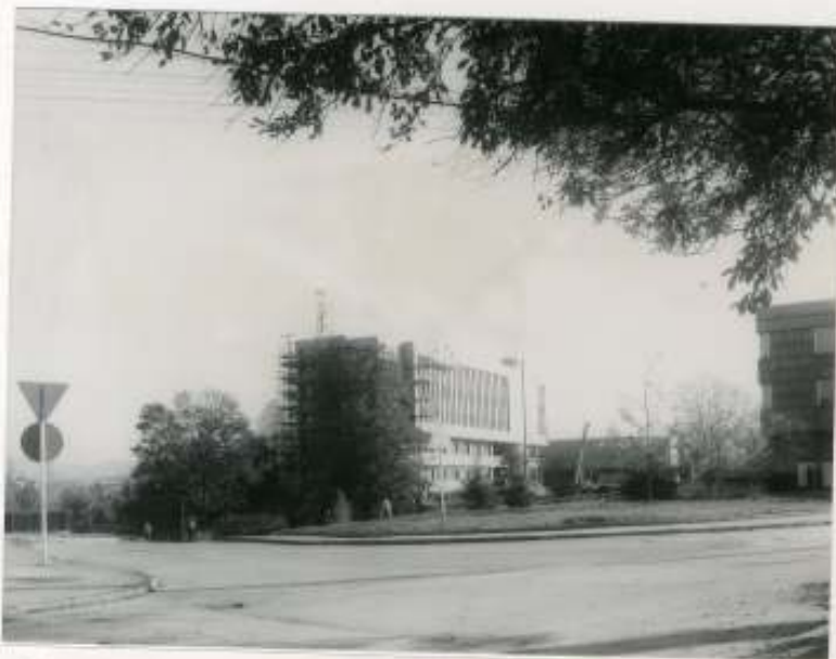
42. Pohľad z ulice Na bráne smerom k novostavbe OV KSS mimo hraníc MPR. V priestore je potrebná citlivá úprava okolitého terénu v nadväznosti na predpokladané terénne a sadové úpravy podnože MPR. foto Jurík 1987
