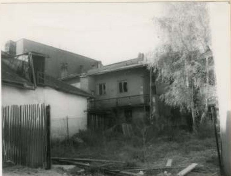
51. Makovického ulice, pohľad na časť rezervnej plochy R 2/B odporúčanej na dostavbu uzatvárajúcu blok na nám. Dukla. Foto dokumentuje absolútne neuspokojivý stav sadných parcel objektov na námestí a ich nepriaznivý dojem na návštevníka MPR prosmo v srdci rezervácie. foto Jurík 1988
