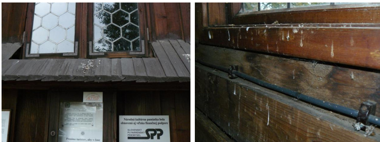
Obr. 3.1-2. Exteriér: znečistenie vtáčim trusom pod oknom na západnej strane Interiér: znečistenie prenikajúce cez škáry v okne
