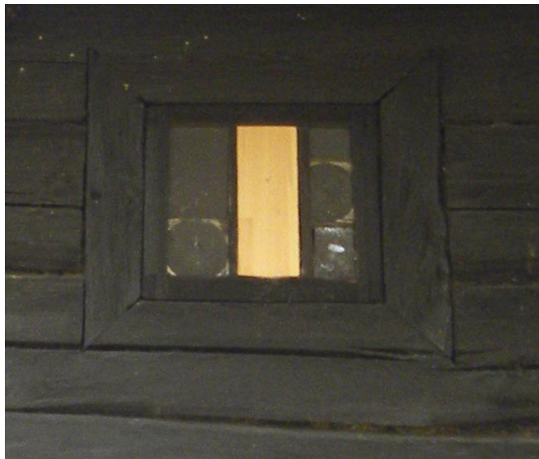
Obr. 7.2. Okno na severnej strane kostola provizórne vyplnené drevenou doskou
