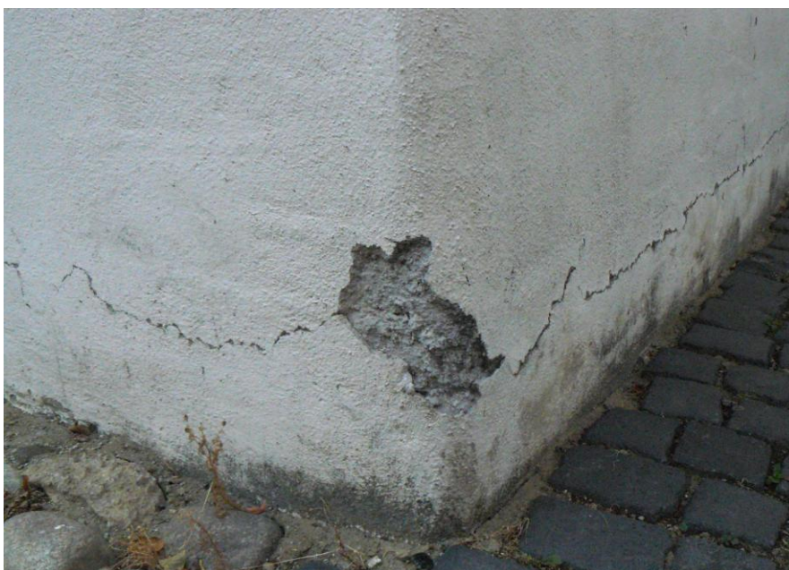
Obr. 4.3. Trhliny v omietke, aj s opadnutím omietky s bielym náterom, nad úrovňou dlažby
