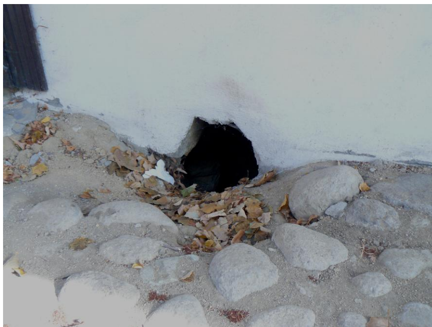
Obr. 4.2. Diera v omietke pri vchode z južnej strany kostola
