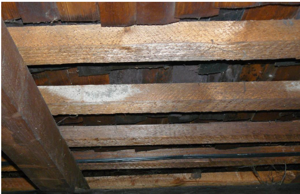
Obr. 8.1. Nosná konštrukcia strechy zo spodnej strany napadnutá mikroorganizmami
