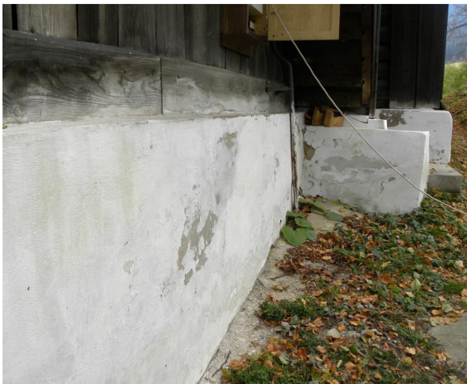
Obr. 6.3. Vlhkostné fľaky a opadaná omietka na južnej stene kostola
