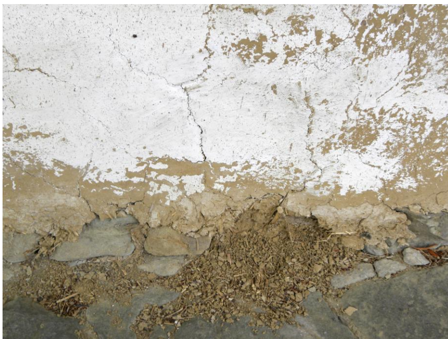
Obr. 2.1. Poškodená a opadaná omietka kamenného sokla (hlavne v úrovni nad zemou) po celom obvode kostola so zvyškami bieleho náteru
