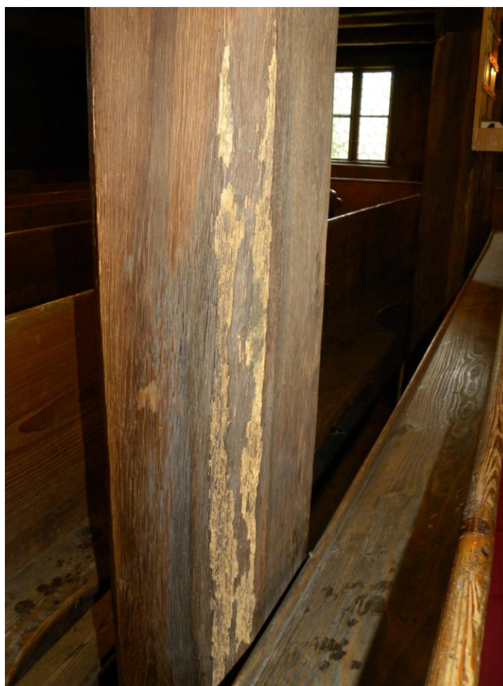
Obr. 3.3. Detail nosného stĺpu pod severnou emprou – poškodenie drevokazným hmyzom
