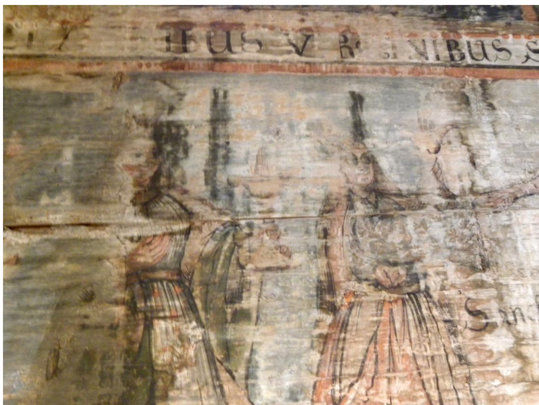
Obr. 2.4. Výrazné poškodenie bohatej výzdoby severnej a južnej steny v hlavnej lodi vplyvom zatekania a navlhania z minulosti (vymývanie pigmentu maľby)
