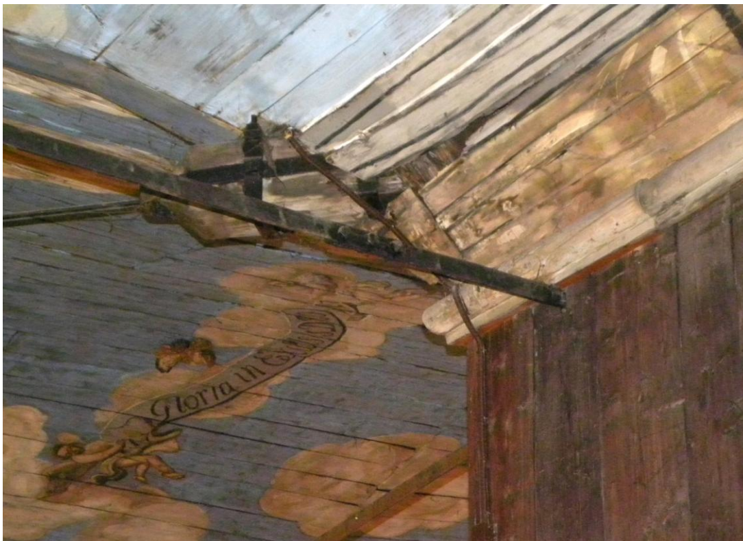
Obr. 4.7. Poškodenie pravého rohu severnej empory
