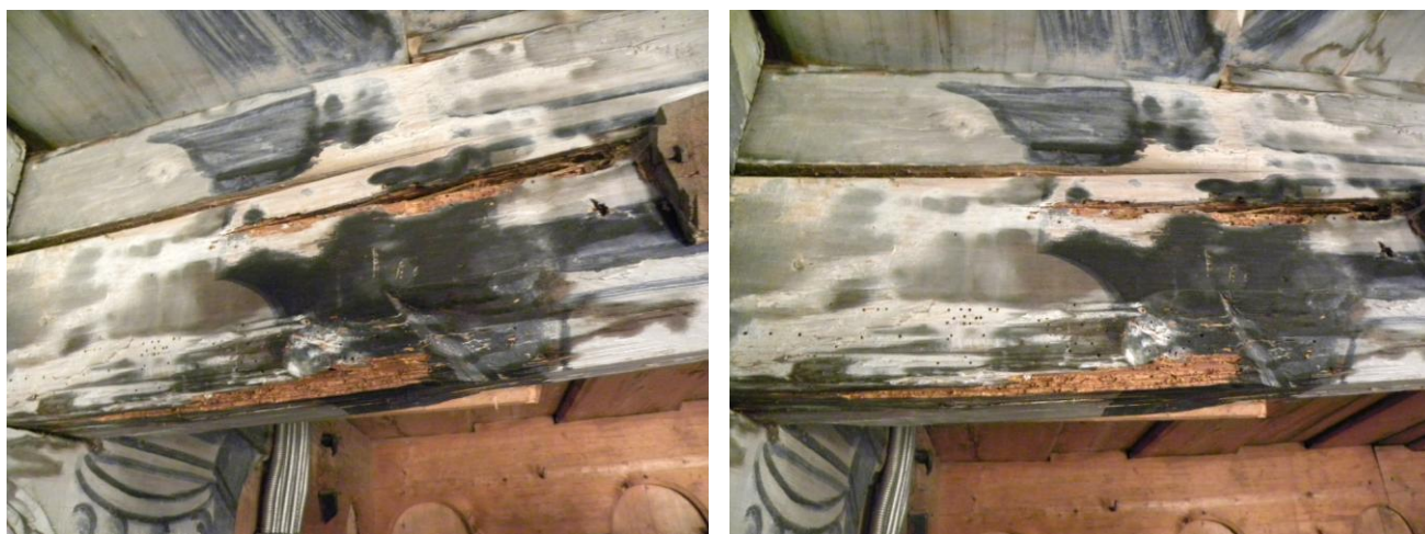
Obr. 6.4. Poškodenie stropného trámu nad východnou emporou so stopami po zatekaní z minulosti, porovnanie stavu z roku 2012. K výrazným zmenám v priebehu roku nedošlo.
