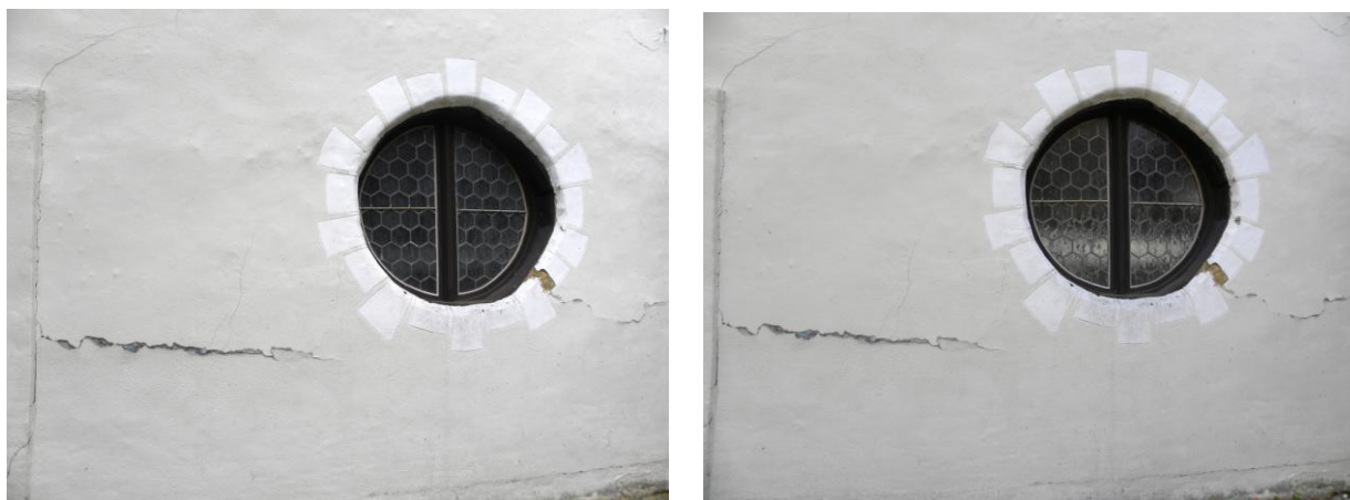
Obr. 4.4-5. Vertikálne trhliny v omietke na západnej stene severného ramena, k výraznejším zmenám oproti r. 2012 nedošlo
