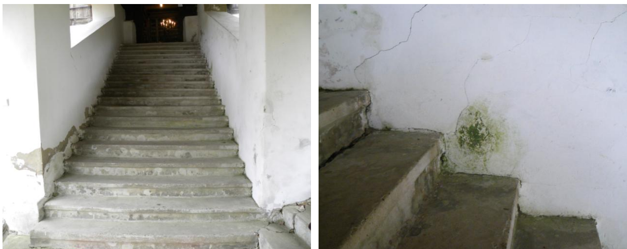
Obr. 6.1-2. Schodisko k hlavnému vstupu: viditeľné fľaky po zavlhnutí, solné výkvetvy a praskliny. Detail schodiska pri vstupe do kostola: praskliny na omietke machový porast
