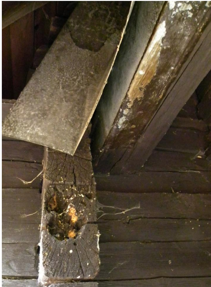
Obr. 7.4. Trám na južnej strane objektu podliehajúci biodegradácii
