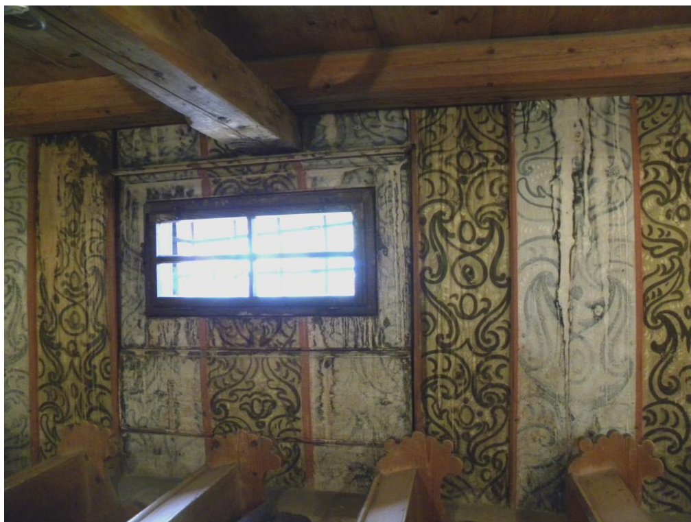
Obr. 6.5. Severná stena interiéru - stopy po zatekaní z minulosti. Vplyvom zavlhania došlo k poškodeniu maliarskej výzdoby na strope aj stenách
