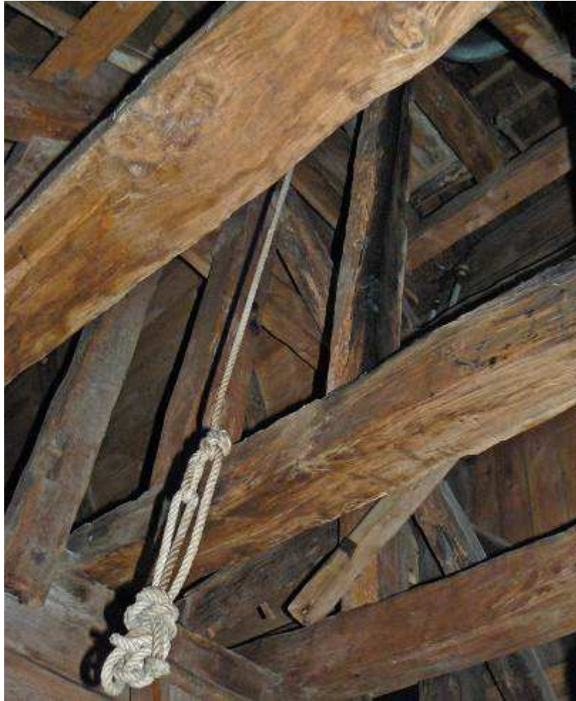
Obr. 7.2. Drevené trámy vo zvonici poškodené v dôsledku zatekania cez okenné otvory veže.
