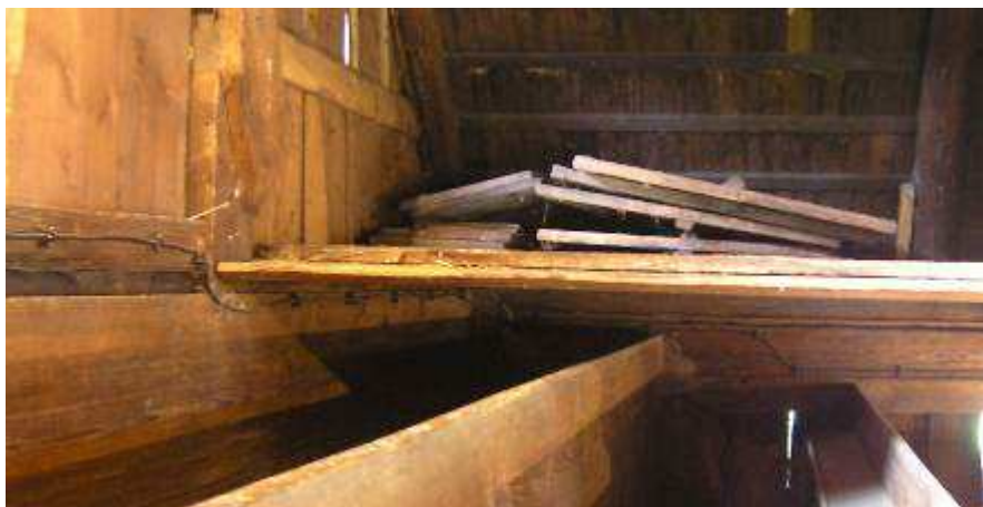
Obr. 3.7. Dlhodobo neudržiavané podkrovné priestory na južnej empore.
