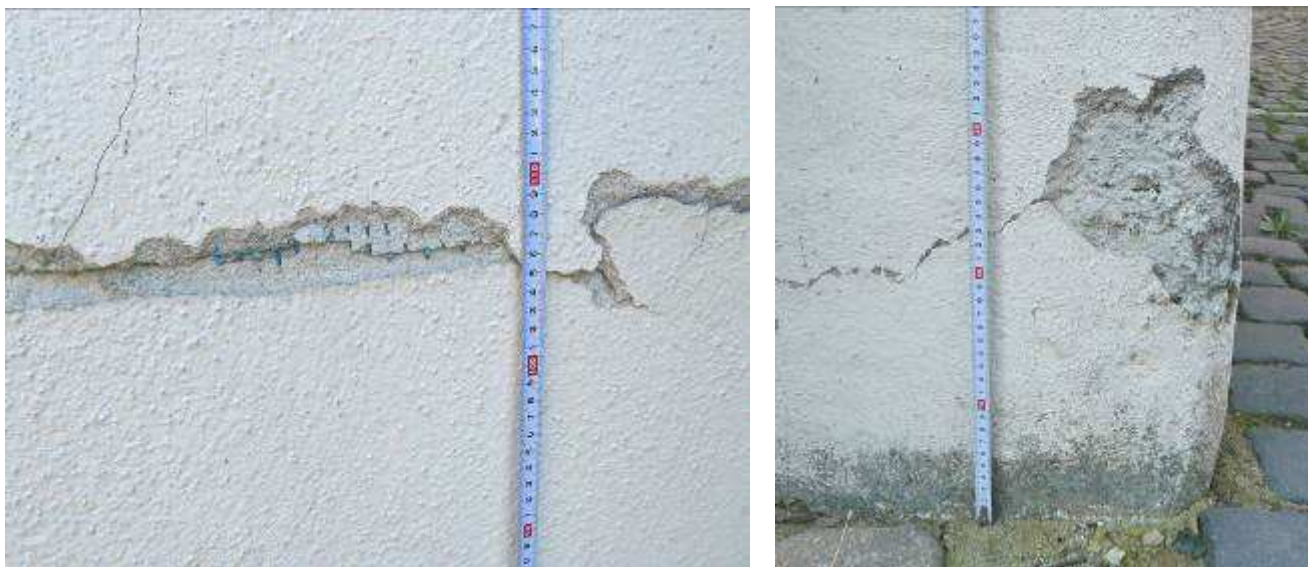
Obr. 4.2-3. Detail trhliny na západnej stene severného ramena (dochádza až k obnaženiu pletiva) a poškodenia severozápadného rohu západného ramena.
