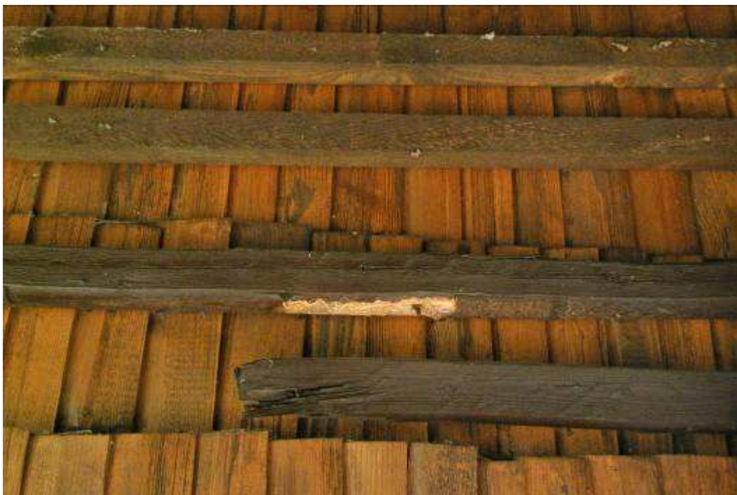
Obr. 2.3. Degradácia dreva na nosnej konštrukcii drevnej krytiny spôsobená drevokazným hmyzom.
