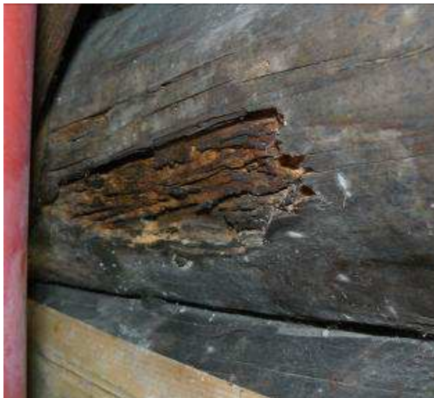
Obr. 6.5. Detail poškodenia drevnej hmoty pri vstupných dverách vľavo za hasiacim prístrojom.
