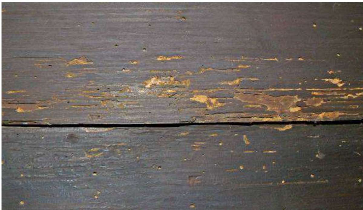
Obr. 5.6. Drevené obloženie na severnej stene – viditeľný pokročilý stupeň biodegradácie s mechanickým poškodením - rozkladom drevnej hmoty.
