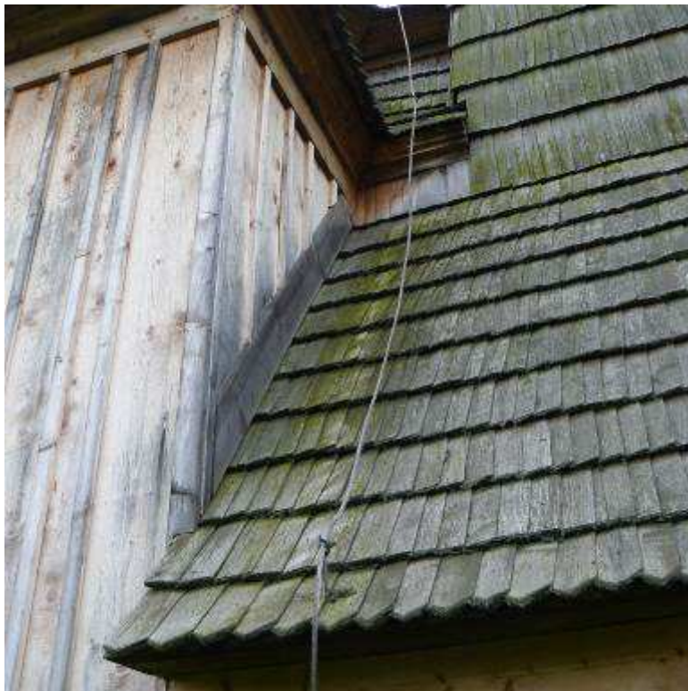
Obr. 5.2. Strešná krytina na severnej strane lokálne obrastená nižšími rastlinami.
