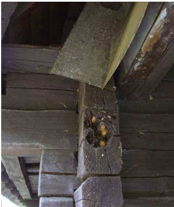
Obr. 7.4. Trám na južnej strane objektu poškodený v dôsledku vody stekajúcej z rímsy.
