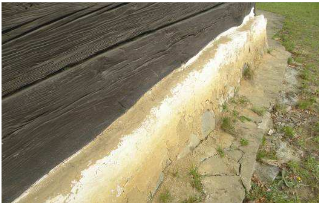
Obr. 2.2. Poškodená a opadaná omietka kamenného sokla. V miestach, kde náter chýba, je mazanica obnažená a dochádza k jej zvetrávaniu.
