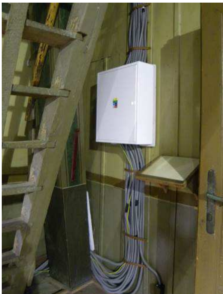
Obr. 2.4. Detail novej elektroinštalácie v objekte.
