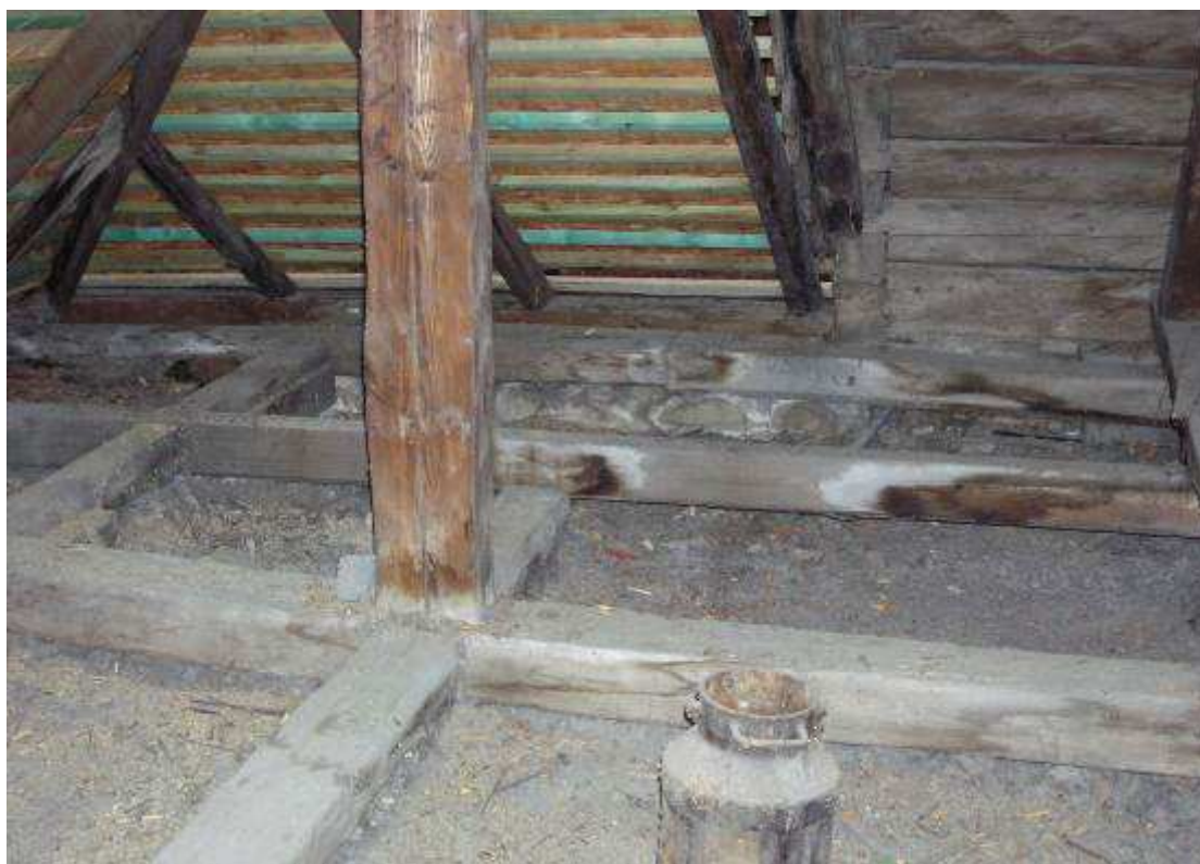
Obr. 4.9. Dlhodobo neudržiavané podkrovné priestory v blízkosti južnej empy.
