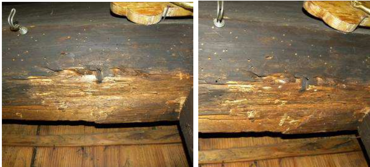
Obr. 5.4-5. Nosný trám nad ikonostasom postihnutý vysokým stupňom biodegradácie (detail s výletovými otvormi po drevokaznom hmyze) – porovnanie so stavom z roku 2013 (vpravo) Výraznejšie zmeny neboli pozorované.
