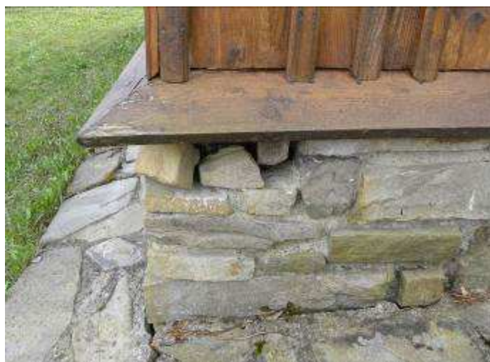
Obr. 1.2. Poškodený roh na juhovýchodnej strane objektu.
