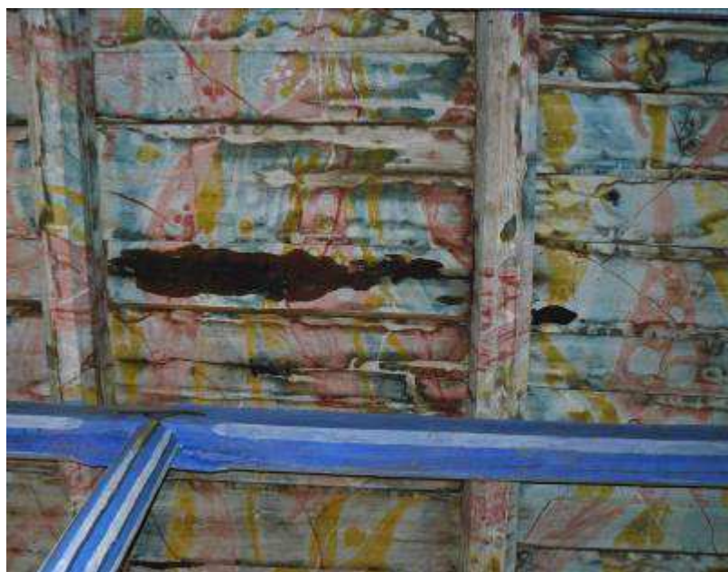
Obr. 6.6. Strop s bohatou maliarskou výzdobou – poškodenie v dôsledku zatekania, v strede sa nachádza tmavý fľak.
