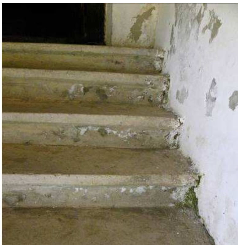
Obr. 6.4. Detail schodiska pri vstupe do kostola s opadanou omietkou, machovým porastom a soľnými fľakmi.
