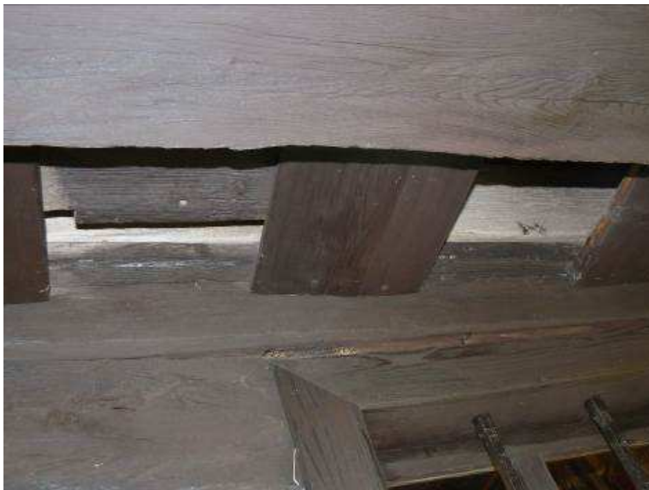
Obr. 7.3. Chýbajúce dosky dreveného obloženia pod strechou na južnej strane lode.
