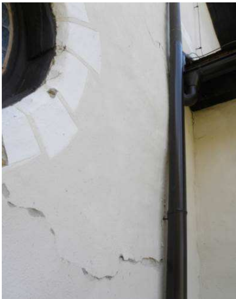
Obr. 4.4. Trhlina v omietke nad oknom na západnej stene severného ramena – omietka sa vydúva a hrozí jej odpadnutie.
