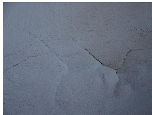
Obr. 68 Popraskaná omietka na severnej strane kostola.
