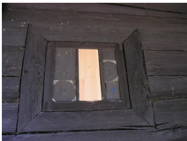
Obr. 83 Okno na severnej strane kostola provízorne vyplnené drevenou doskou.
