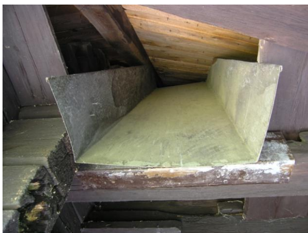
Obr. 81 Trám na južnej strane objektu poškodený v dôsledku vody stekajúcej z rímsy.
