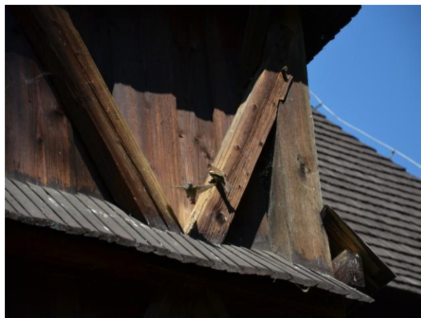
Obr. 23 Znečistenie exteriéru objektu trusom drobného vtáctva.
