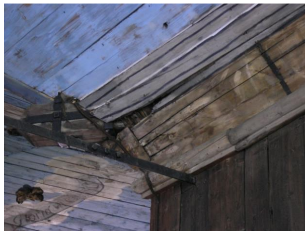
Obr. 37 Poškodenie pravého rohu severnej empyry.
