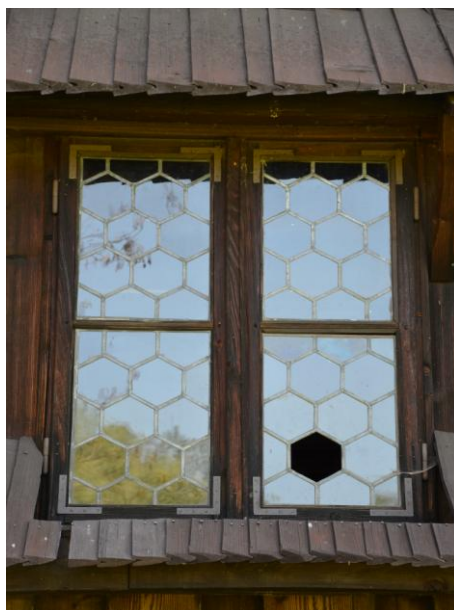
Obr. 21 Chýbajúci šesťuholník okennej výplne okna na východnej strane objektu.
