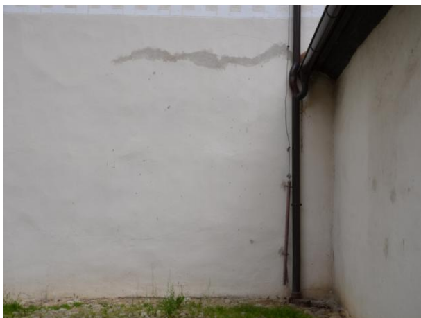
Obr. 33 Šetrne vyplnené trhliny v omietke na južnej stene západného ramena a vznikajúce nové trhliny.
