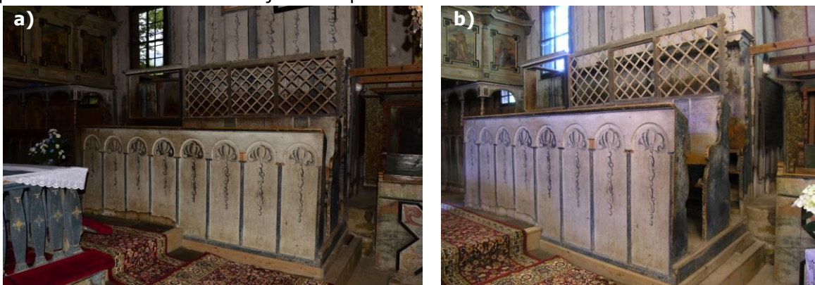
Obr. 75 Zmeškalovská lavica navíha zospodu z južnej strany kostola, poškodená farebná vrstva v porovnaní rokov a) 2015 a b) 2016.
