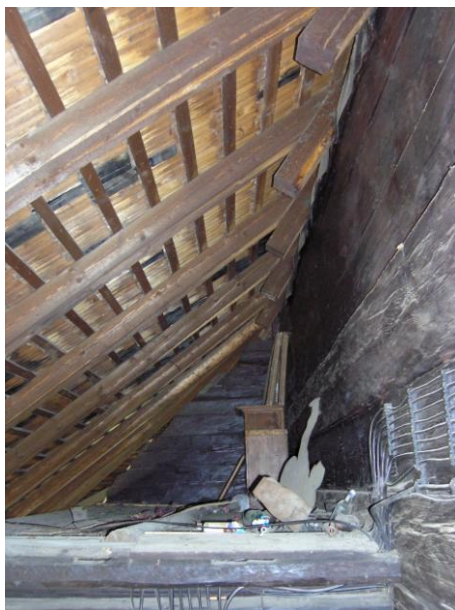
Obr. 96 Dlhodobo neudržiavaný priestor pod strechou z južnej strany.
