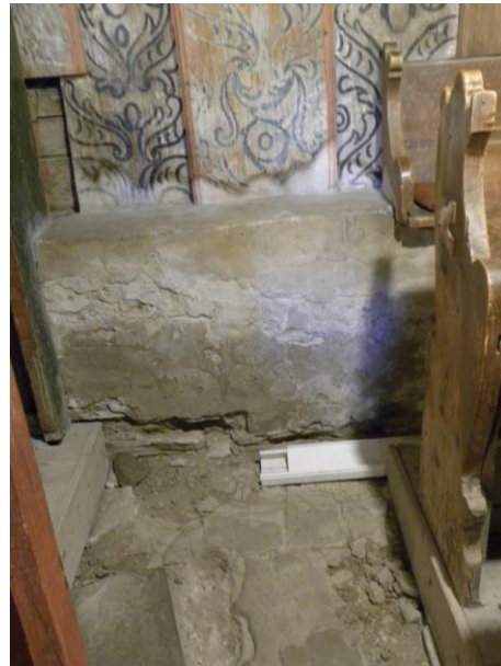
Obr. 70 Biele fláky na omietke sokla na južnej strane svedčia o zavlhávaní a zasolení.
