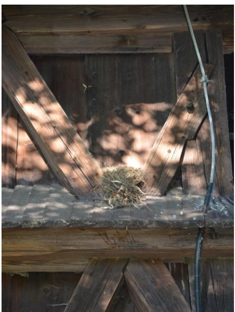
Obr. 22 Hniezdenie vtáctva v mieste spojov šikmých trámov hrádzenej konštrukcie.
