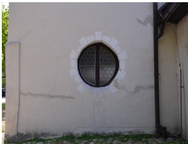
Obr. 34 Šetrne vyplnené trhliny v omietke na západnej stene severného ramena a vznikajúce nové trhliny.
