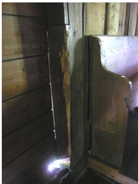
Obr. 26 Nosný stĺp poškodený drevokazným hmyzom, juhovýchodná časť za oltárom.
