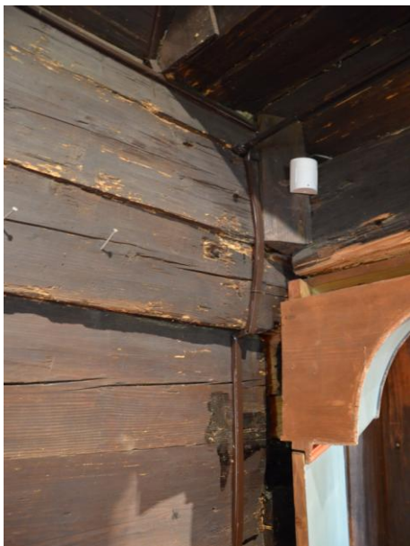
Obr. 51 Drewná hmota južnej steny presbytéria s viditeľným stupňom biodegradácie s mechanickým poškodením – rozkladom drewnej hmoty.
