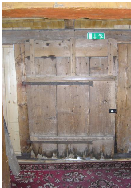
Obr. 9 Zatekanie pozorované na poškodených vchodových dverách.
