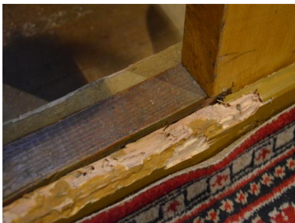
Obr. 7 Lišty lavíc, mechanicky poškodená drevná hmota.
