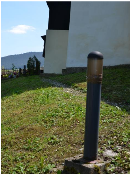
Obr. 63 Opravený stĺpik osvetlenia vedúceho do kostola lepiacou páskou.
