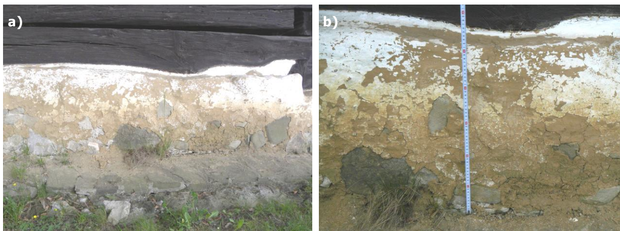
Obr. 14 a) Poškodená a opadaná omietka kamenného sokla. V miestach, kde náter chýba, je mazanica obnažená a dochádza k jej zvetrávaniu. b) Porovnanie s minulým rokom máj 2015, vpravo.
