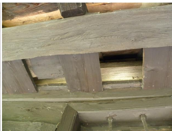
Obr. 82 Chýbajúce dosky dreveného obloženia pod strechou na južnej strane lode.
