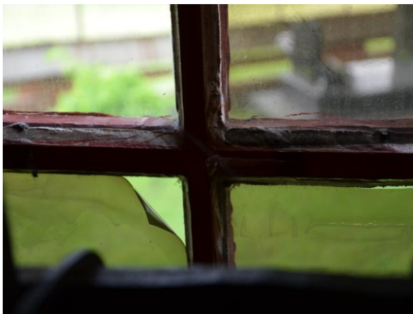
Obr. 57 Poškodená nepriliehajúca ochranná fólia na oknách.
