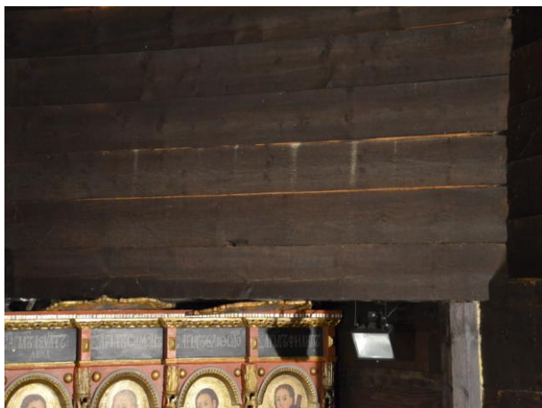
Obr. 53 Degradovaná drewná hmota na južnej stene presbytéria.
