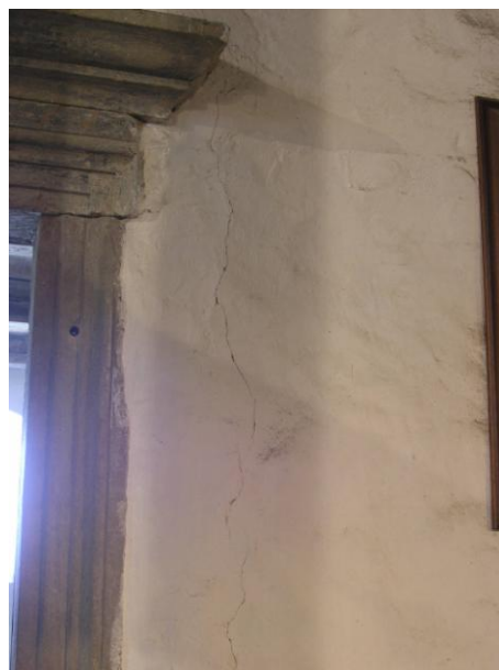
Obr. 39 Trhlina pozdĺž steny kamenného portálu v sakristii.
