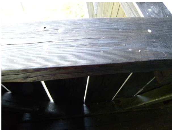
Obr. 65 Znečistenie vonkajšieho zábradlia trusom drobného vtáctva.
