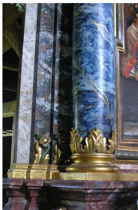
Obr. 30 Uvoľnená farebná vrstva na architektonickom stípe.
