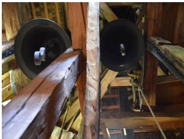
Obr. 86 Poškodenie niektorých trámov vo veži.
