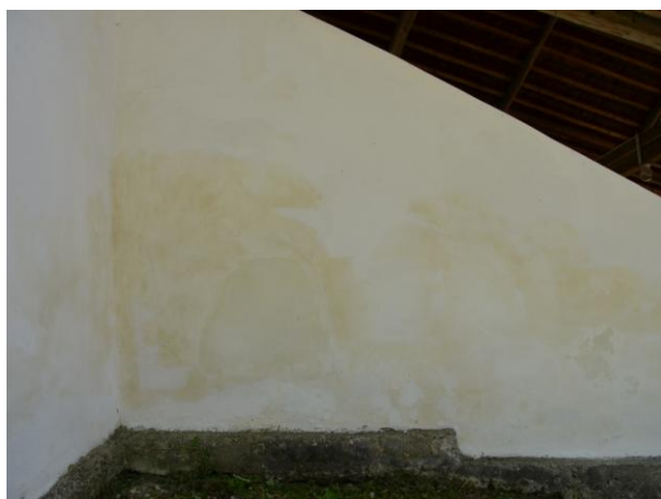
Obr. 67 Vlhkostné fláky prenikajúce cez nový náter omietky ľavého múra na vonkajšej strane schodiska.
