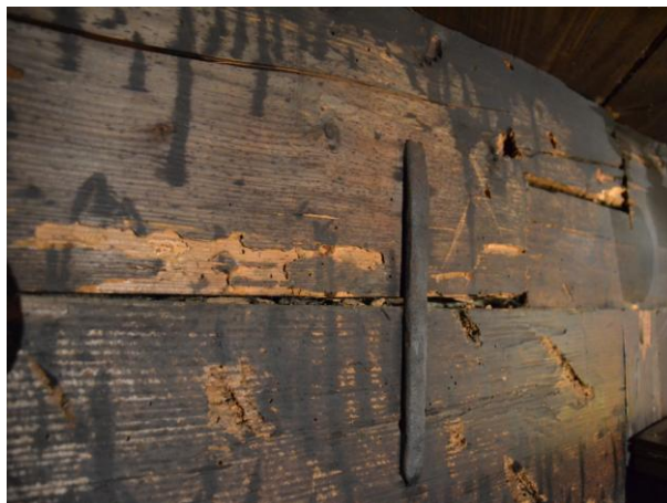
Obr. 52 Tmavé fľaky na drewnom obložení empory, so značným poškodením drewnej hmoty.
