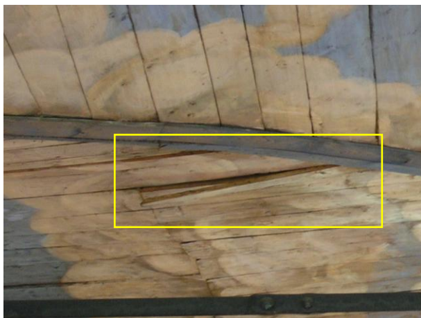
Obr. 36 Prečnievajúca uvoľnená doska z maľovaného obloženia stropu v mieste kríženia klenieb.
