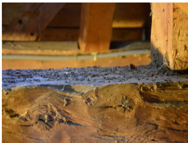
Obr. 88 Poškodenie niektorých trámov vo veži.
