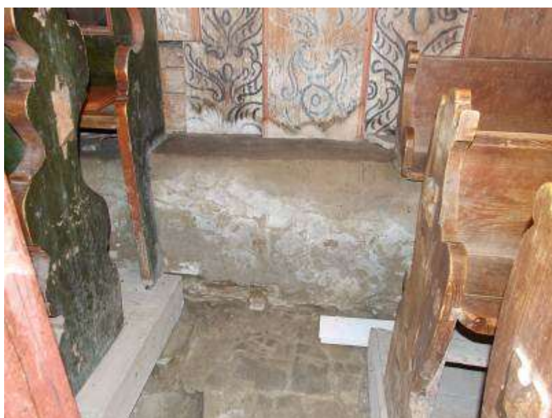
Obr. 6.5. Biele fľaky na omietke sokla na južnej strane v interiéri nasvedčujú zasolenie.
