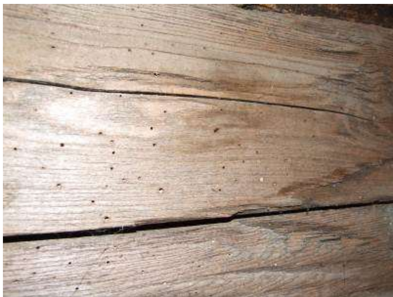
Obr. 7.2. Výletové otvory po drevokaznom hmyze v zrubovej konštrukcii hlavnej lode.
