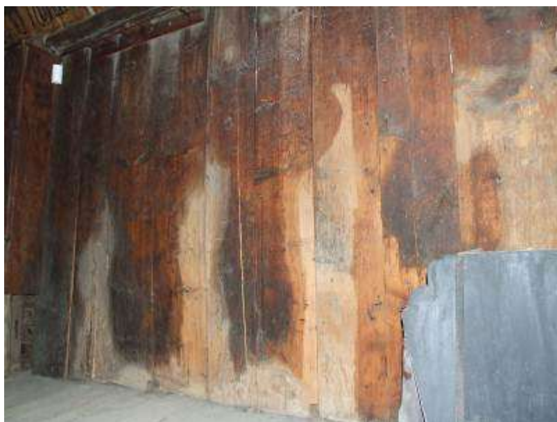
Obr. 4.6. Fľaky na empore (Z stena), ktoré pravdepodobne nesúvisia s presakovaním vody.
