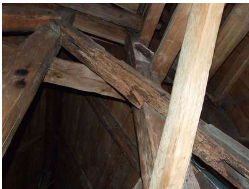
Obr. 7.6. Poškodenie trámov vo veži bolo pozorované na viacerých miestach.
