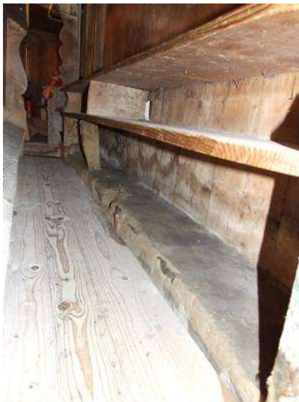
Obr. 6.7. Vplyvom vzliňania vody prichádza k zavíhaniu doskového obloženia na južnej strane kostola.
