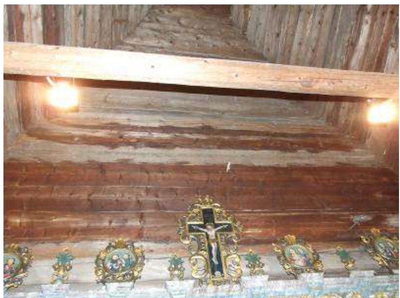
Obr. 1.4. Stopy po zatekaní na strope lode spôsobené čistiacimi prácami v exteriéri.
