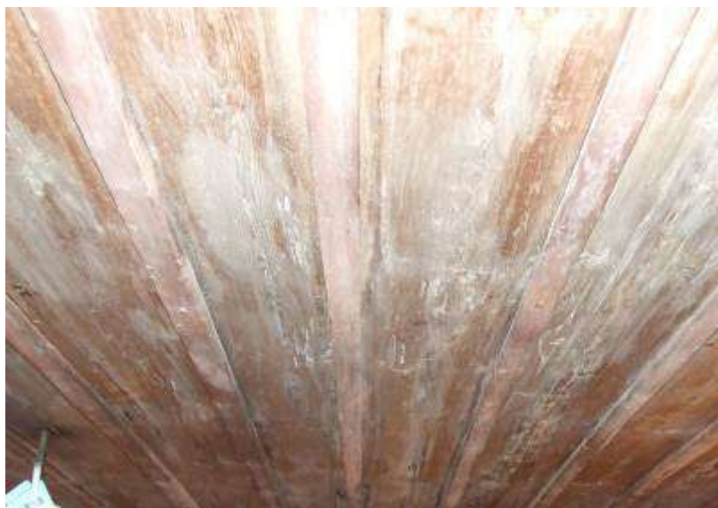
Obr. 2.6. Obloženie stropu v lodi s rozsiahlym výskytom výletových otvorov po drevokaznom hmyze
