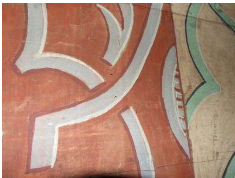
Obr. 8.4. Výletové otvory po drevokaznom hmyze boli pozorované v hlavnej lodi len na maľovanom doskovom opláštení, a to sporadicky.
