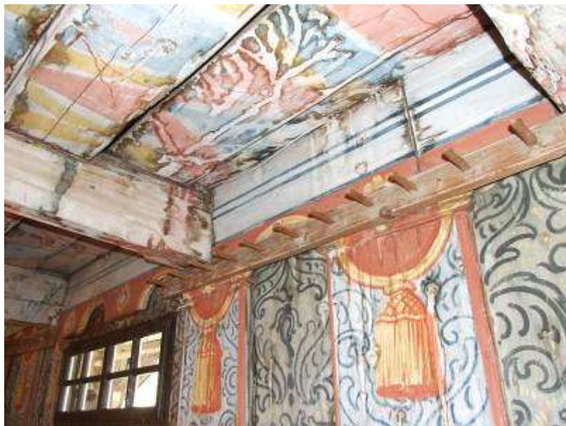
Obr. 6.8. Na strope boli pozorované staršie stopy po zatekaní zasahujúce aj na obvodové steny. Vplyvom zavíhania došlo k poškodeniu maliarskej výzdoby stropu aj stien.
