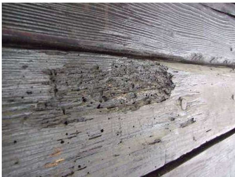
Obr. 8.2. Staršie rozsiahle stopy po napadnutí drevokazným hmyzom na vonkajšej strane zrubovej konštrukcie.
