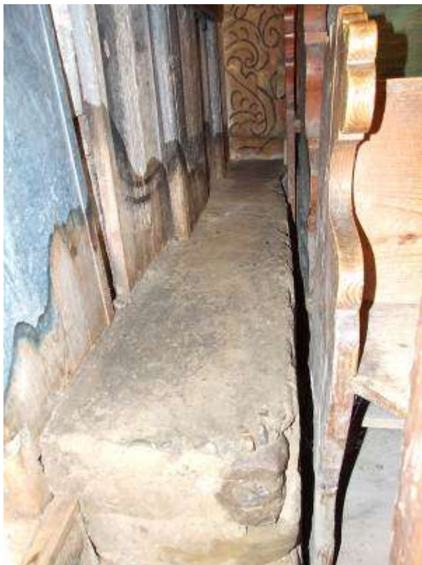
Obr. 6.6. Na južnej strane kostola v mieste nasadania zrubovej konštrukcie s opláštením na kamenný sokel boli pozorované recentné stopy po zavíhaní. Maliarska výzdoba je v miestach zavíhania značne poškodená.
