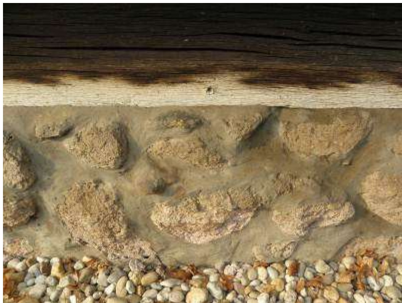
Obr. 3.4. Detail kamenného sokla zloženého z nepravidelných blokov vulkanických hornín (andezitu a andezitového tufu). Tufy sú miestami značne zvetrané a nesúdržné.
