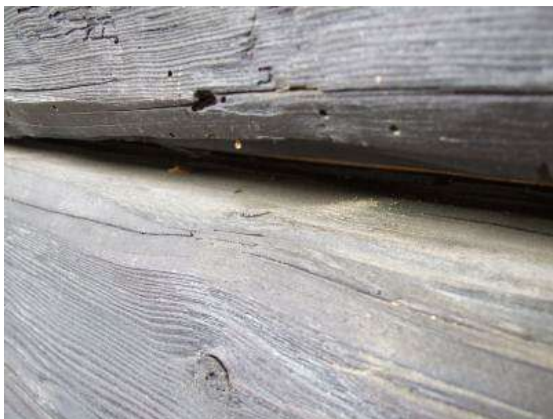
Obr. 8.3. Požerky a výletové otvory po aktívnom drevokaznom hmyze v zrubovej konštrukcii kostola v exteriéri.
