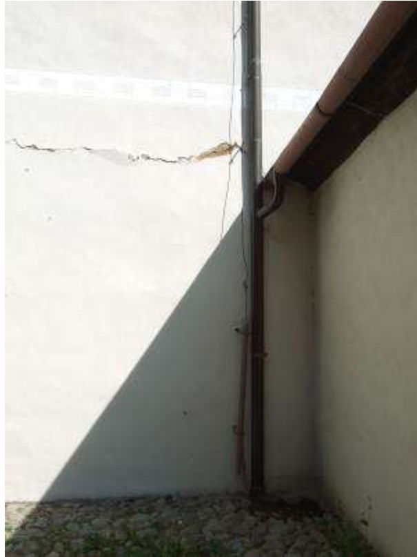
Obr. 4.2. Trhliny v omietke obvodových múrov kostola (južná stena západného ramena).
