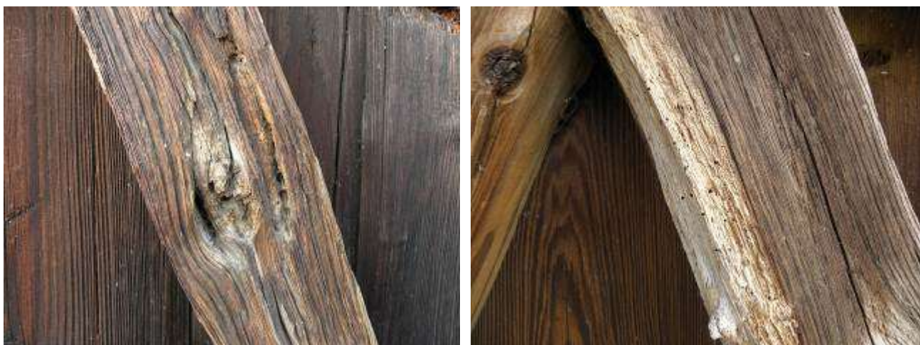
Obr. 3.2-3. Prvky hrazdenej konštrukcie sú miestami vplyvom poveternostných podmienok a vrtavej činnosti drevokazných organizmov degradované.
