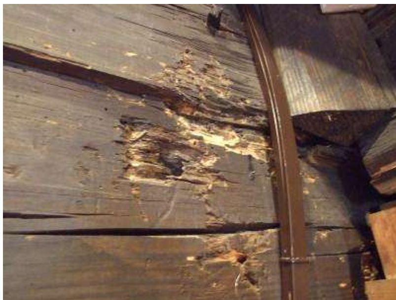
Obr. 5.4. Trámy zrubovej konštrukcie v hlavnej lodi sú lokálne biodegradované s dobre pozorovateľným mechanickým poškodením dreveniny.
