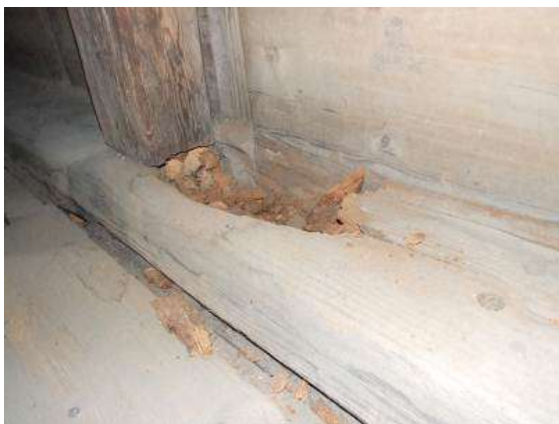
Obr. 4.8. Trám zábradlia spojovacej časti východnej a južnej empory je značne biodegradovaný.
