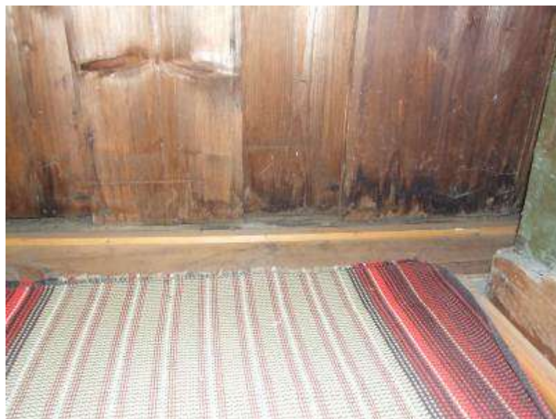
Obr. 3.8. Stopy po zavlhání boli pozorované na spodnej strane opláštenia kostola na južnej strane. Samotná drevina ale nevykazuje výrazné zvýšené hodnoty relatívnej vlhkosti.
