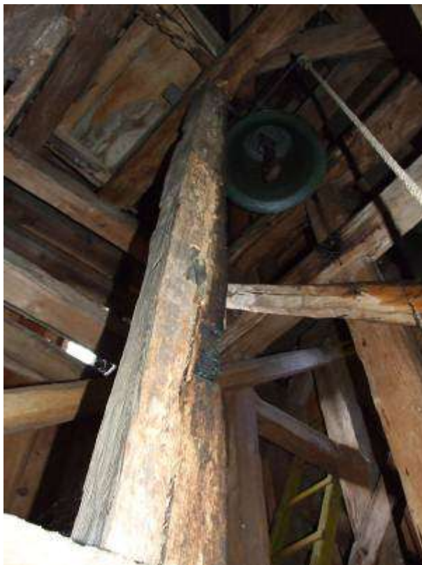
Obr. 7.5. Niektoré trámy vo veži sú poškodené.
