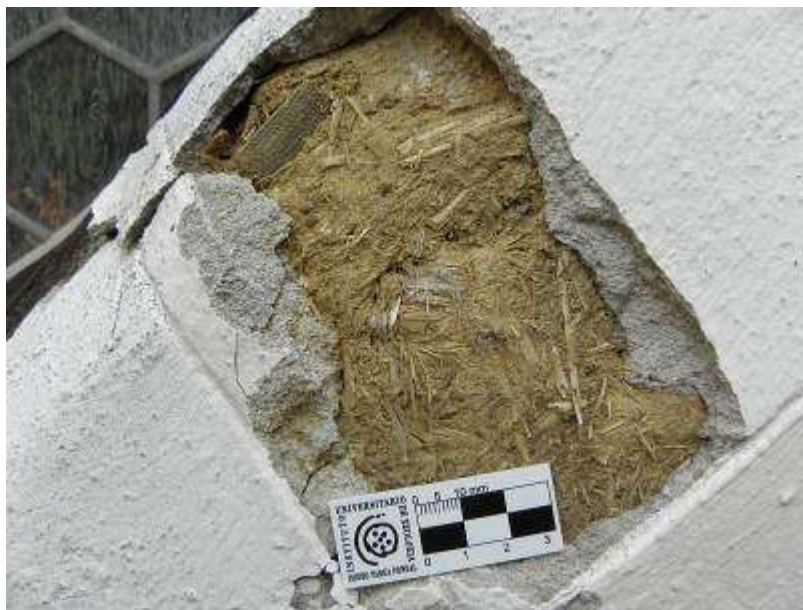
Obr. 4.4. Detail poškodenej omietky a obnaženej mazačnice s rastlinnými makrozbytkami.
