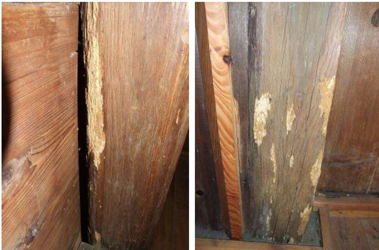
Obr. 3.6-7. Biologické poškodenie stíпов v interiéri kostola. Dobre pozorovateľné stopy po vrtavej činnosti drevokazného hmyzu.
