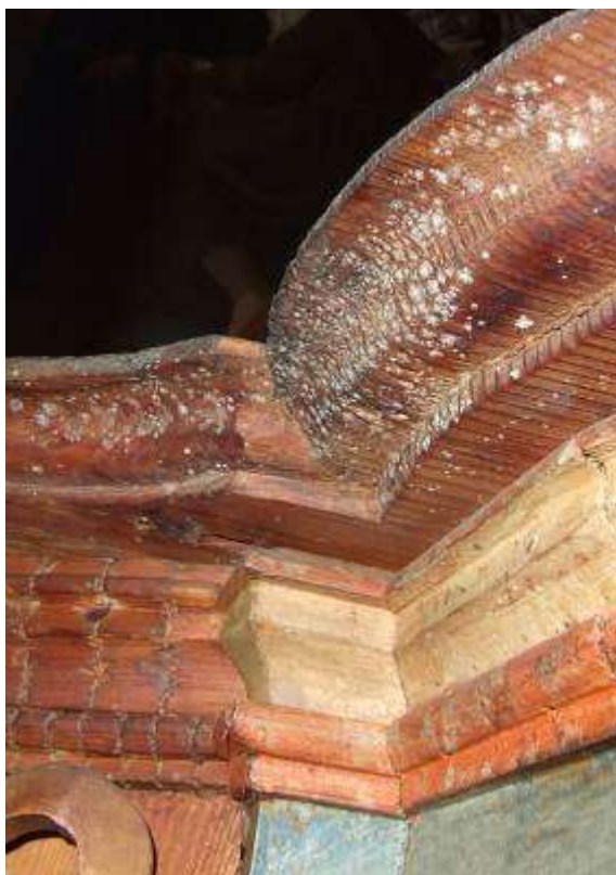
Obr. 8.6. Detail rímsy nad svätostánkom napadnutej plesňami.
