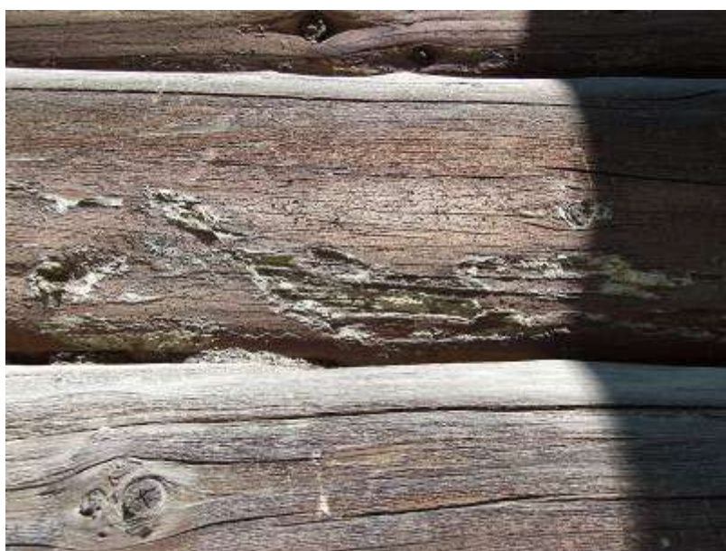
Obr. 6.2. Biologické poškodenie trámu nekyretej zrubovej konštrukcie na južnej stene v exteriéri.
