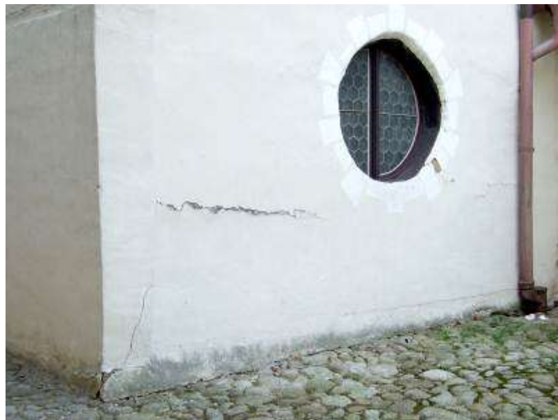
Obr. 4.3. Trhliny v omietke na západnej stene severného ramena.
