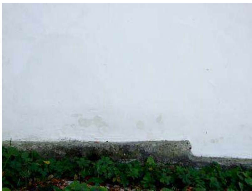
Obr. 6.4. Na severnej strane kostola je dobre pozorovateľné zavlhanie sokla.
