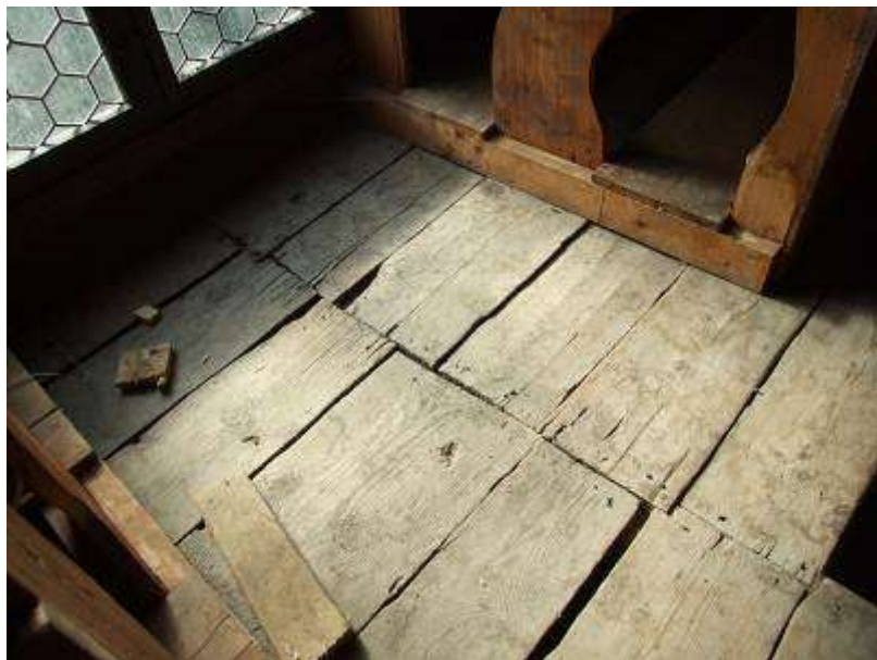
Obr. 4.7. Opatrebovaná podlaha na empore. V miestach spojov prichádza k poškodzovaniu drevených dosiek.
