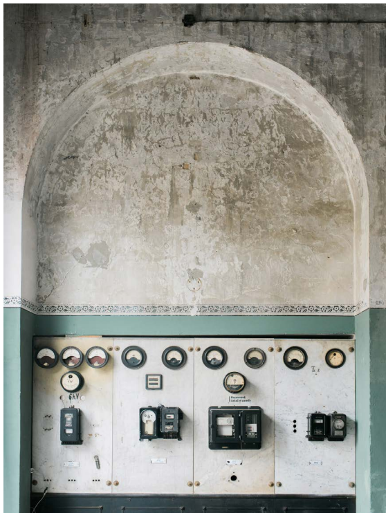
► Obr. 28. Elektrárň č. ÚZPF 10852/1, Piešťany.
