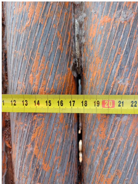
► Obr. 40. Mechanické čistenie lán – nevhodné, Bratislava.
