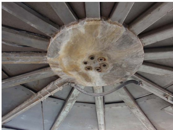
► Obr. 37. Znehodnotenie obkladu zatekaním a koróziou, Bratislava.
