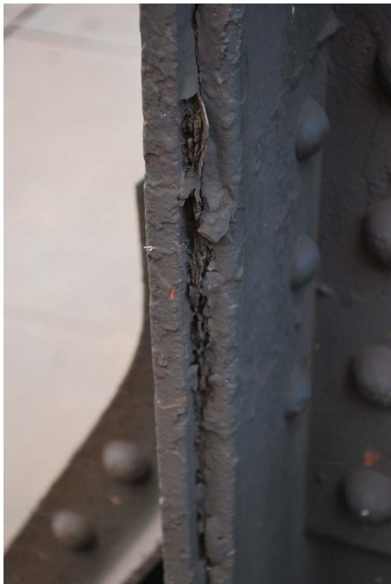
► Obr. 35. Poškodenie protikorozynej ochrany rozpínavosťou korózie, Nižná Myšľa.
