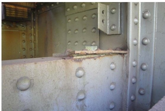
► Obr. 36. Deformácia vplyvom korózie, Strečno.
