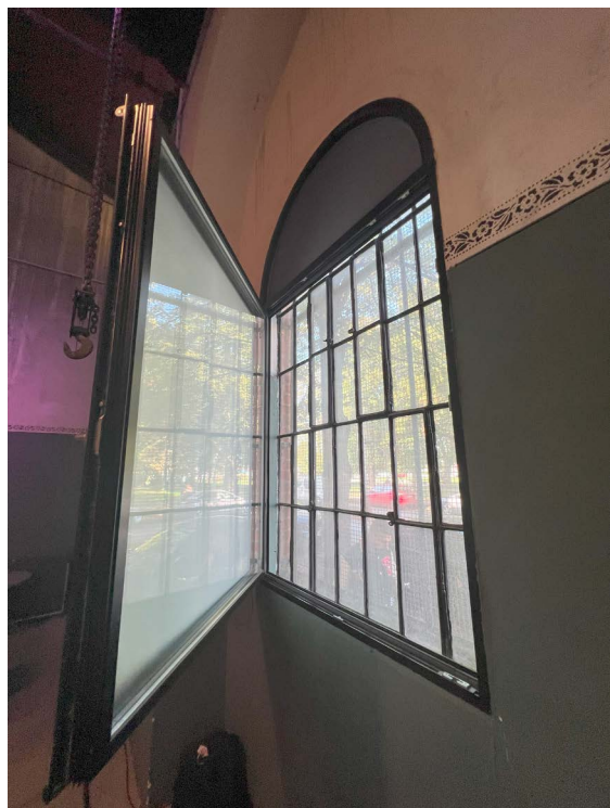
► Obr. 36, 37. Vložené nové kovové vnútorné krídlo k jednoduchému pôvodnému zaskleniu, Elektrárňa Piešťany.
