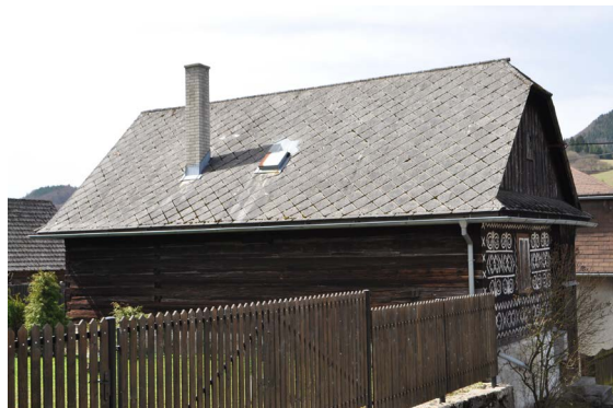
► Obr. 2. Rozšírené strešné krytiny s obsahom škodlivého azbestu v Čičmanoch.
